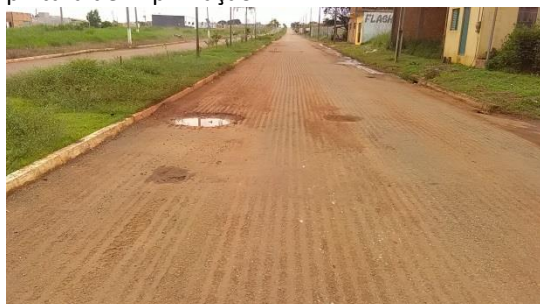
Figura 3 – Disposição longitudinal da falha na pintura de imprimação
