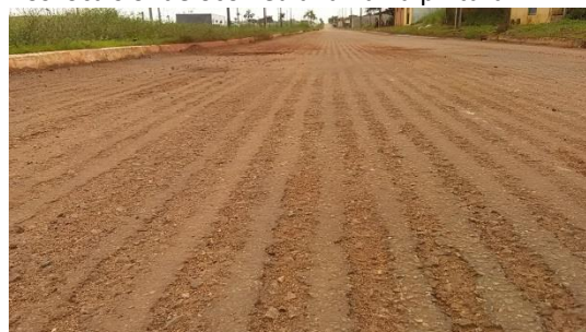
Figura 4 – Detalhe da ausência de mistura asfáltica nos locais onde ocorreu a falha na pintura
